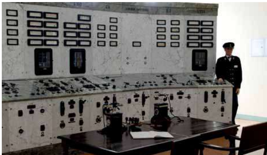
Kontrollrum i Porjus
